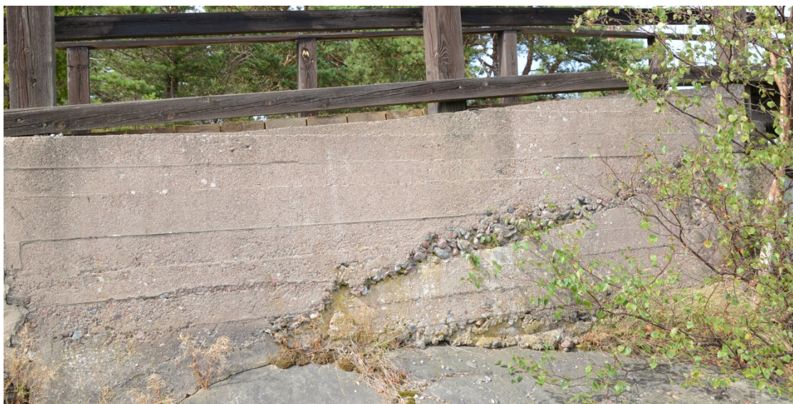
Bild 10. Skada 13, betongskador gjutsår.
