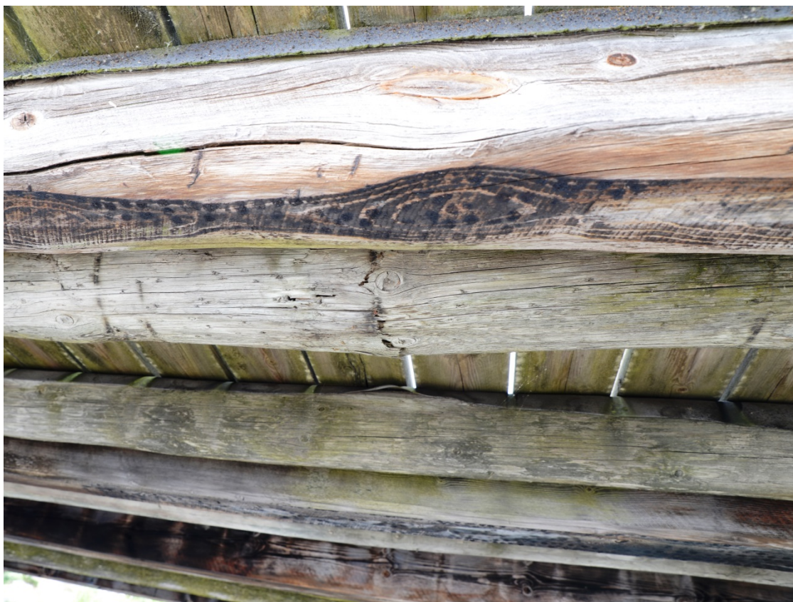
Bild 2. Skada 2 brott på den östra förstärkningsbalken i spann 4.
