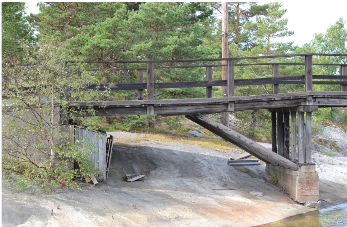
Bild 4. Skada 4, deformation/ nedböjning av spann. Skada 5, träd med rötter som växer in under stödet. Skada 7, urspolning och spjälkning av betong under stöd 2.
