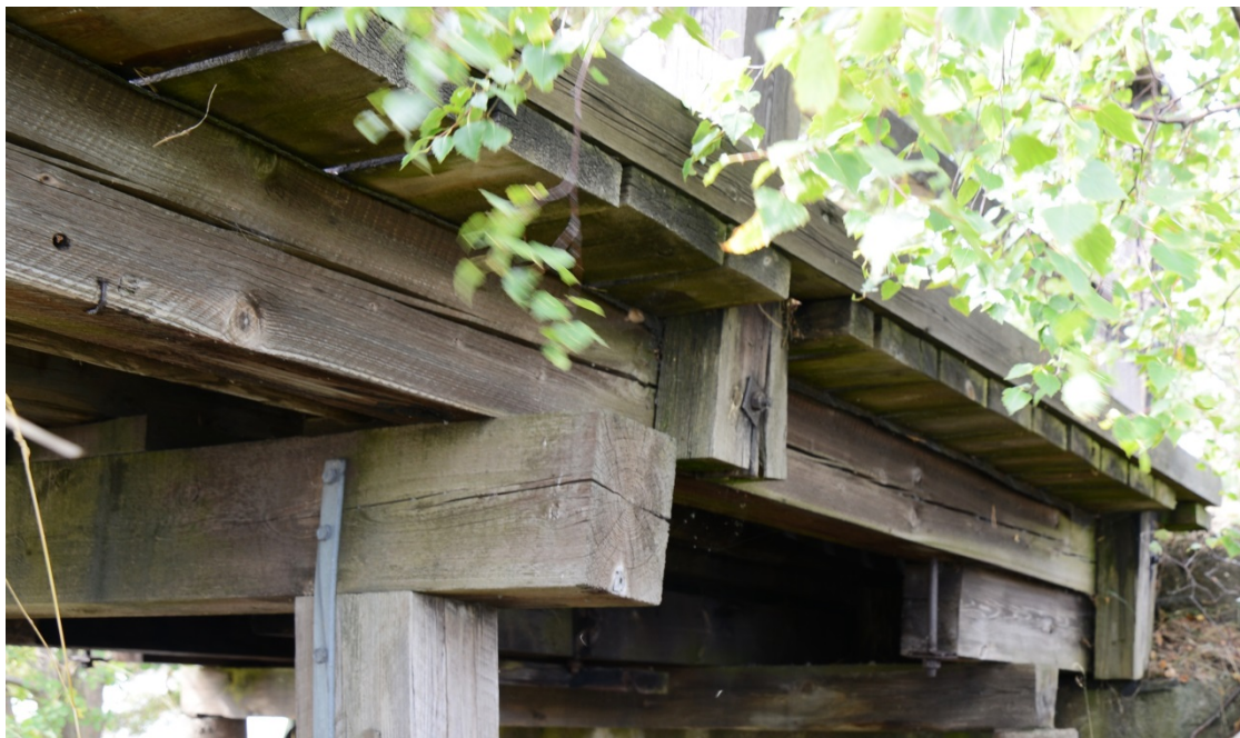
Bild 3. Skada 3, infästning av räcesständer i rutna huvudbalkar, en del av strävorna har även sprickor och rötskador.
