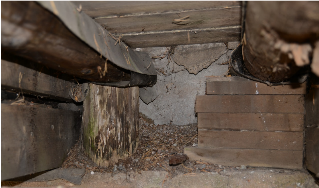
Bild 13. Skada 15, norra landfästet smuts på lagerpall och tveksamma pallningar av extrahuvudbalkar..
