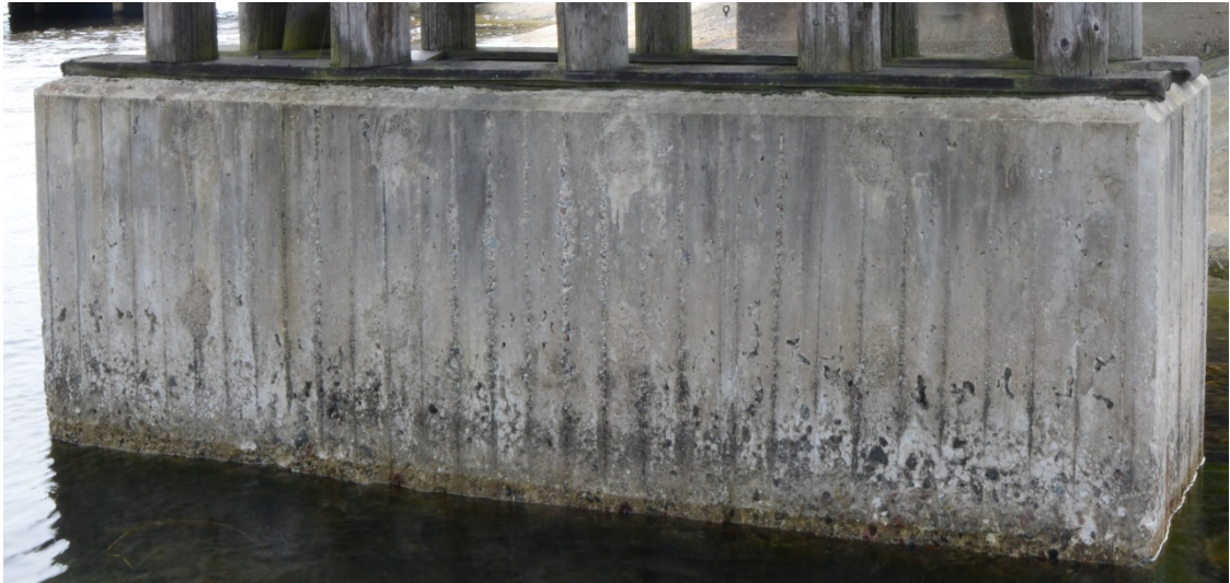
Bild 11. Skada 13, betongskador, vittring.
