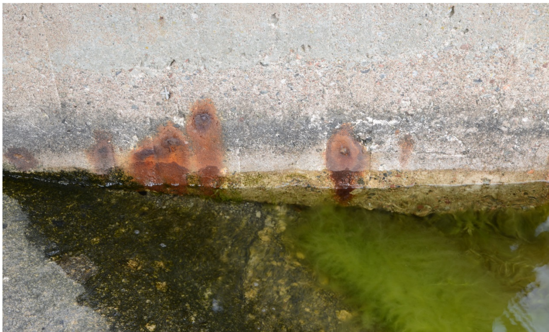
Bild 7. Skada 7, urspolning stöd 6.
