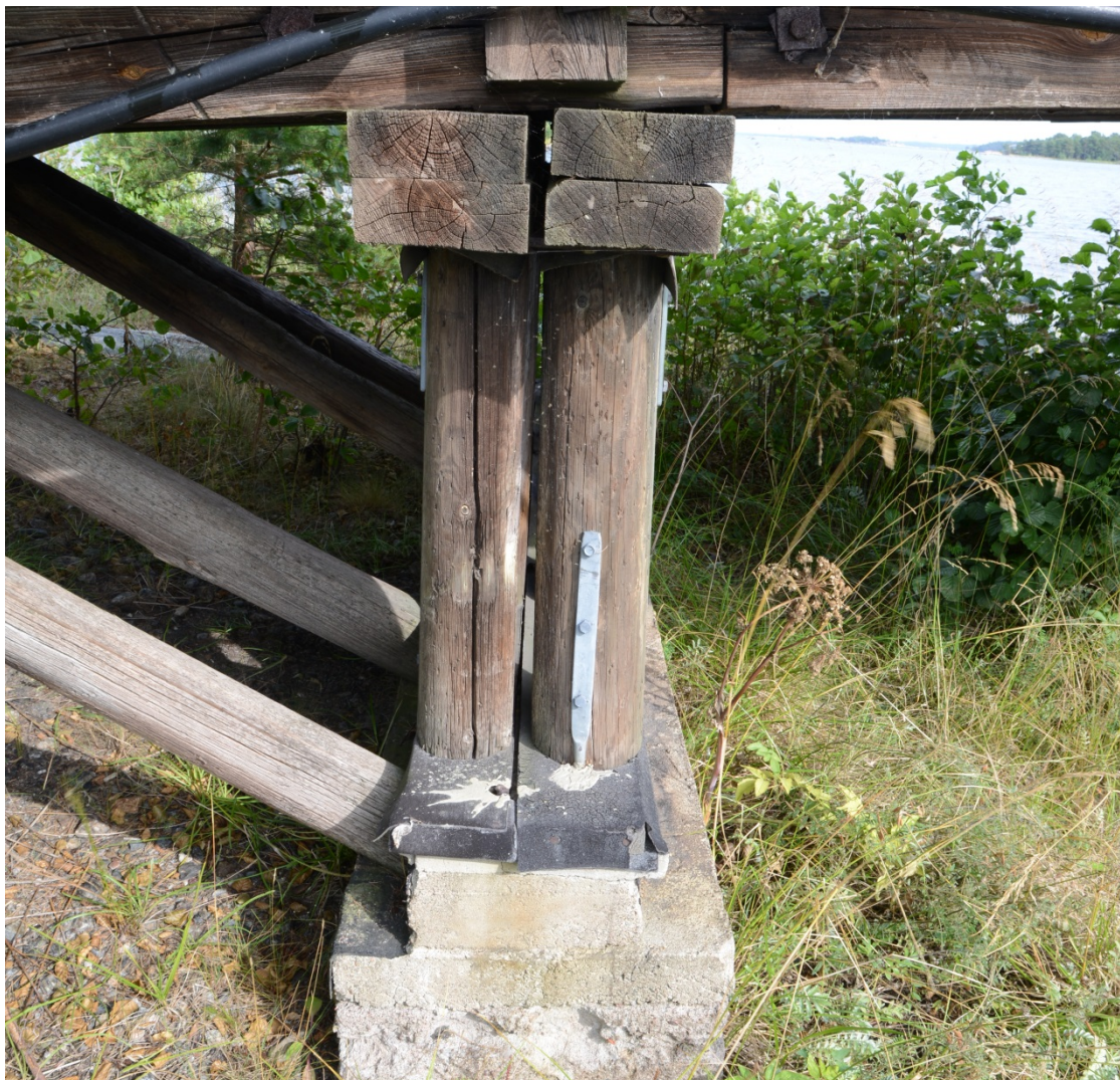
Bild 9. Skada 12, tre av stöden på den norra rampendelen av bron lutar svagt åt söder.
