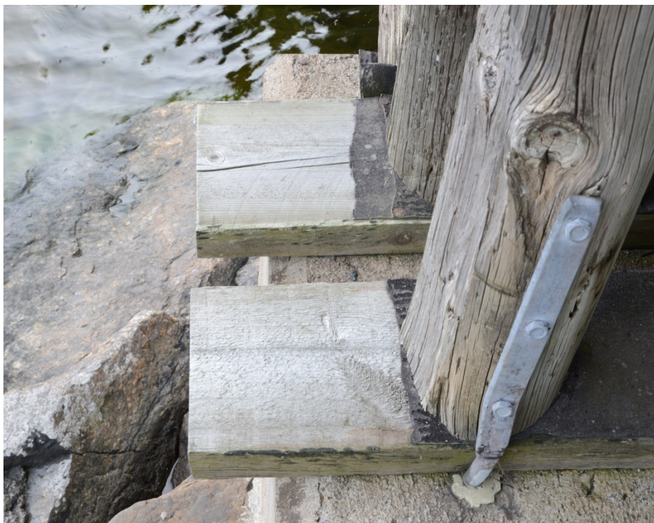
Bild 8. Skada 10, avtäckning på mellanlägg mellan stöd och pelare är skadade på ett flertal ställen på den norra delen av bron.
