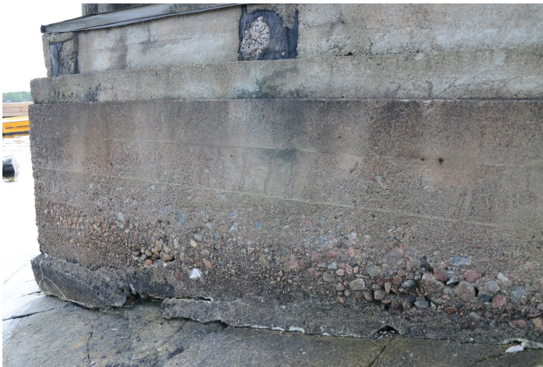
Bild 6. Skada 7, urspolning och spjälkning på grund av frostsprängning, stöd 2.
