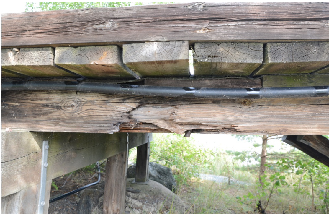
Bild 1. Skada 1, Röta i samtliga huvudbalkar, mest på ovansidan.
