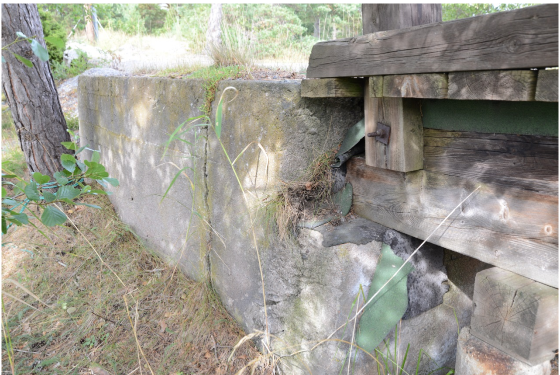
Bild 12. Skada 14, norra landfästet mot väst spricka i stödmur.
