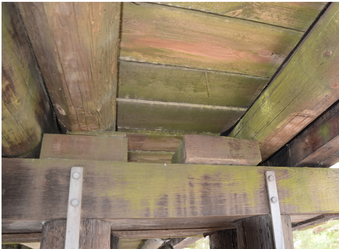
Bild 5. Skada 6, klossning under förstärkningsbalkarna är ej fastsatta och ett flertal är ur sitt ursprungliga läge.
