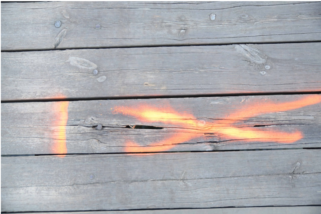
Fig. 4. Skada 17, röta rakt igenom slitplank, spann 2.
