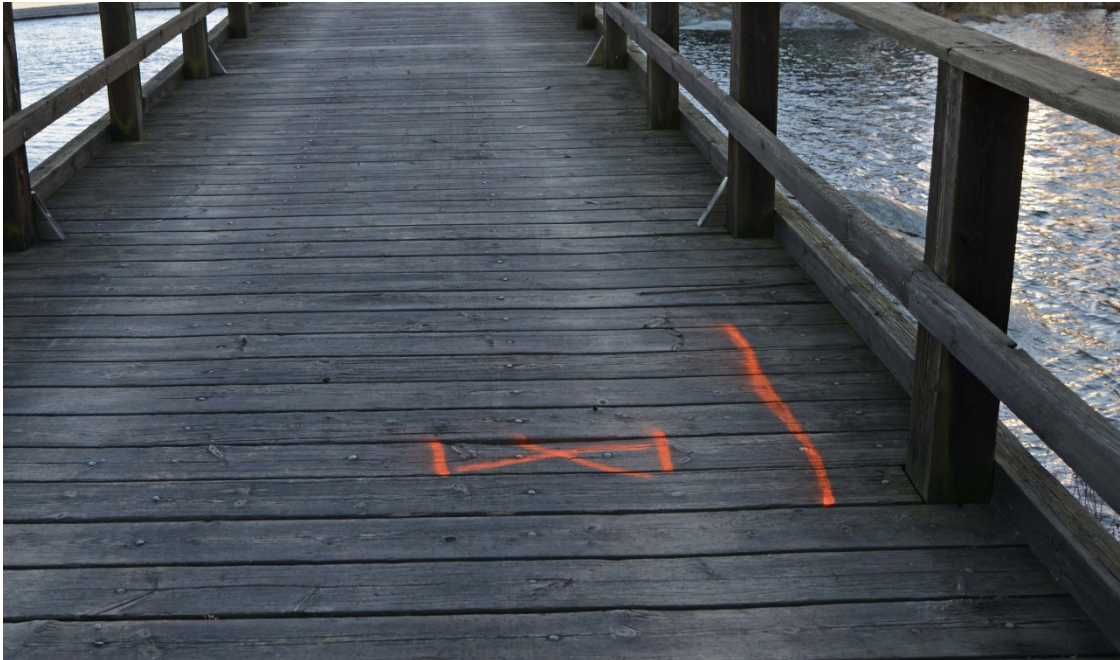
Fig. 3. Skada 16 och 17, spann 11.
