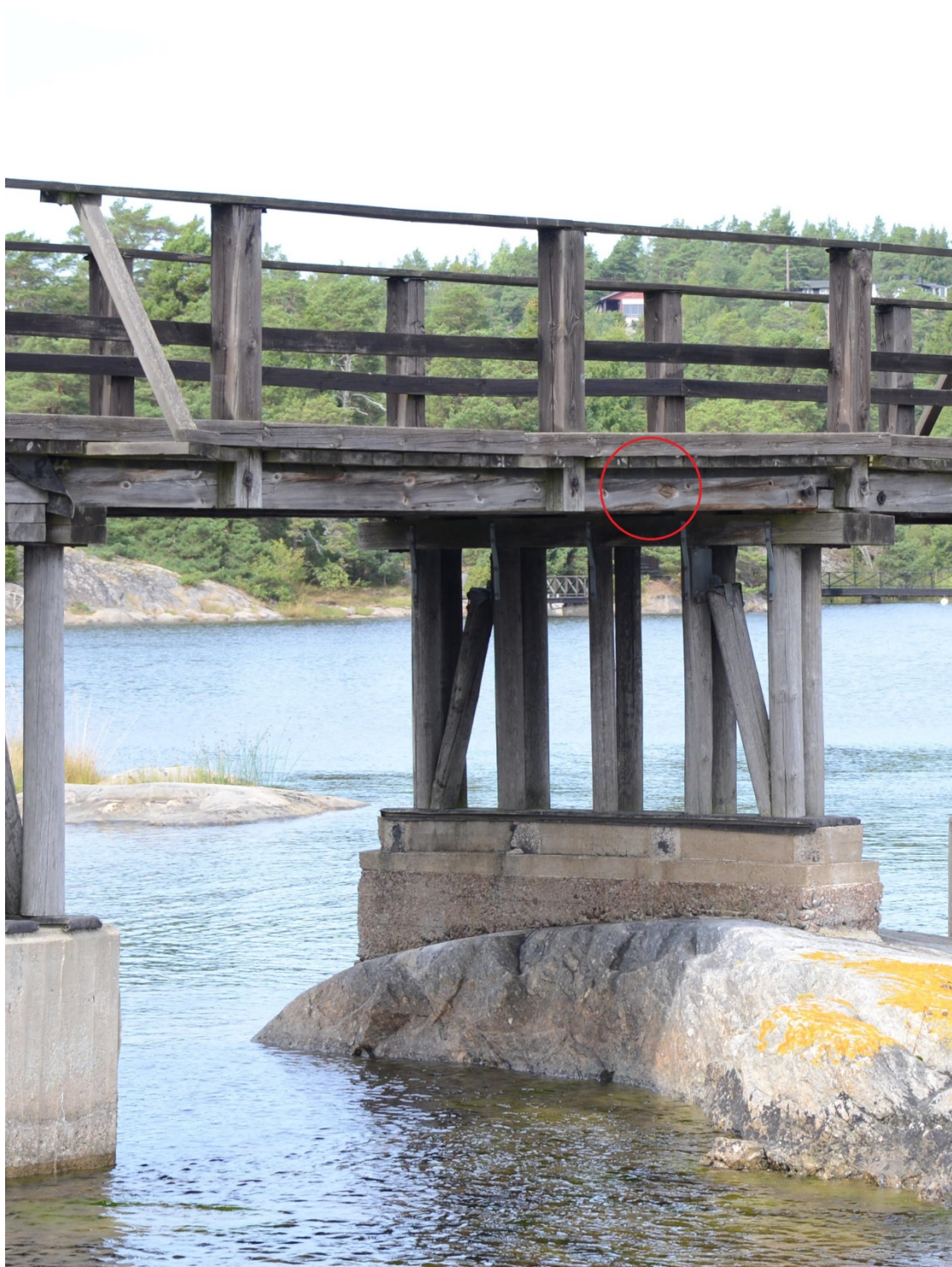
Fig. 1. Skada 2 är lokaliserad på östra sidan av span 4, skadan syns bara från undersidan.
