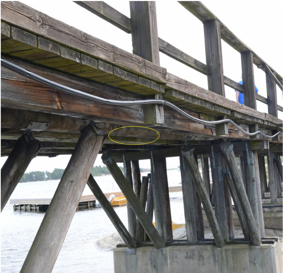
Fig. 2. Skada 16, rötskador i 2a och 3e förstärkningsbalk från väster i spann 6, det längsta spannet.
