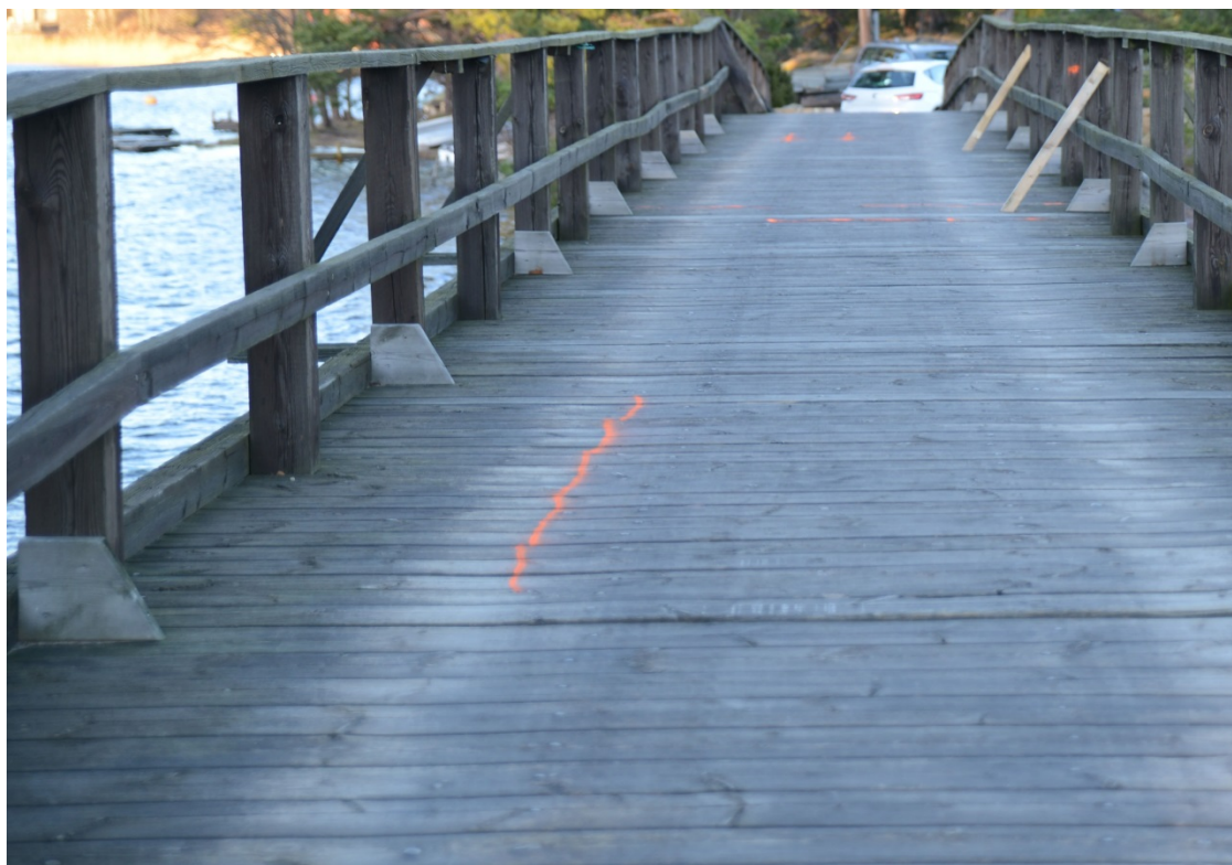
Fig. 5. Skada 18, lösa slitplank, spann 2.
