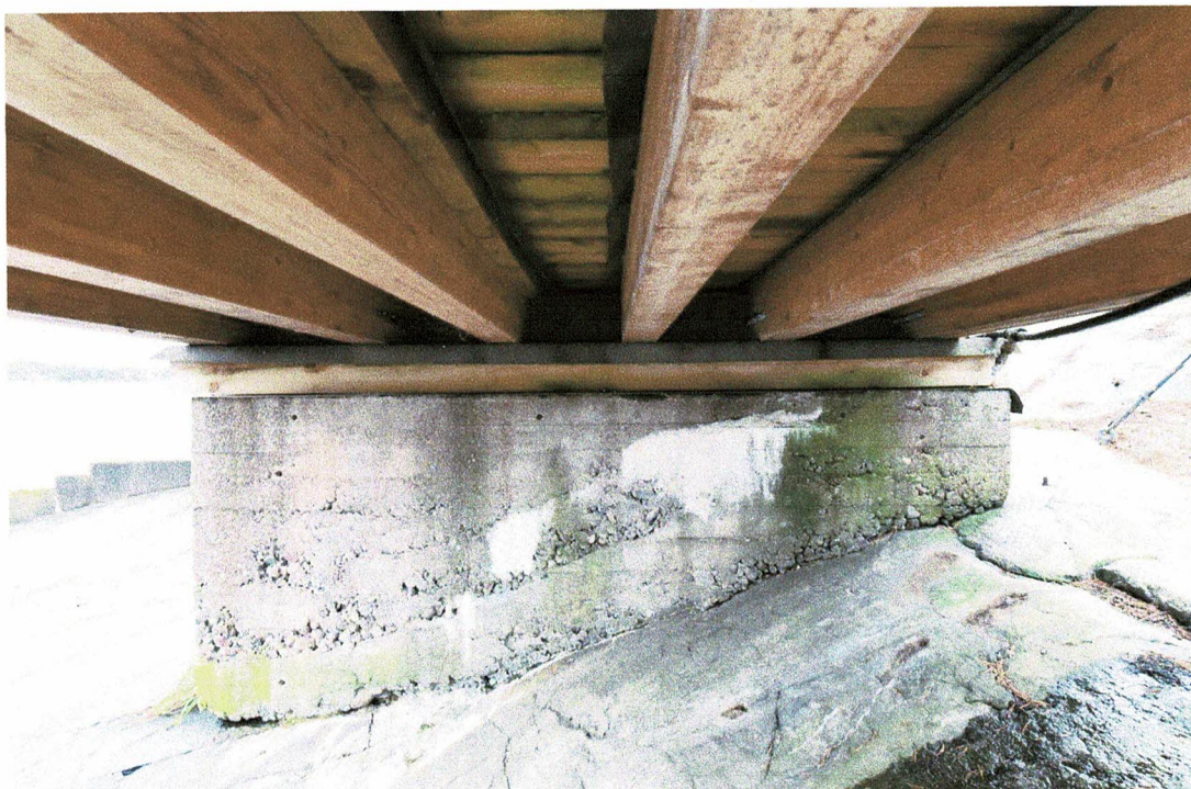
Fig 1. Skada 1 och 2, gjutsår och urlakning på stöd 1.
