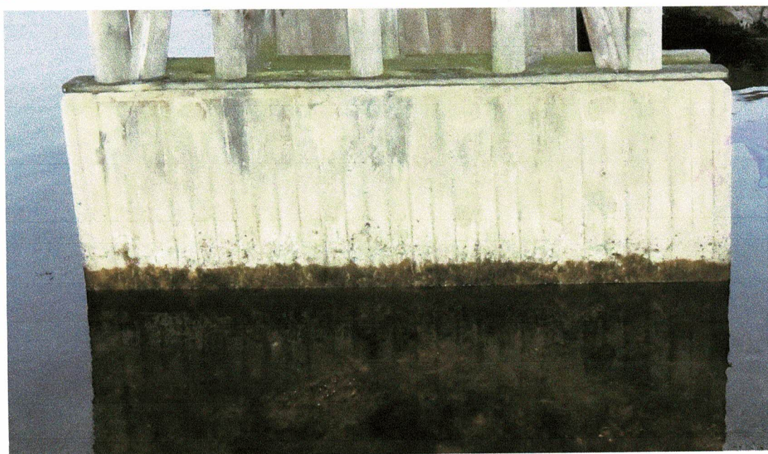
Fig 2. Skada 3, erosion i skvalp-zonen.
